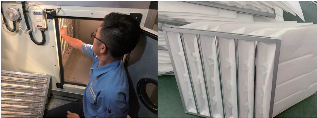
圖二十四 中央空調鍍鋅框袋式濾網
